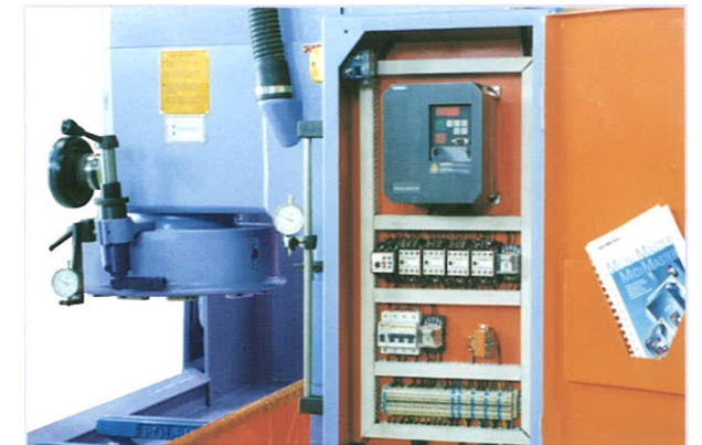
Elektrik Sistemi - Electric System
