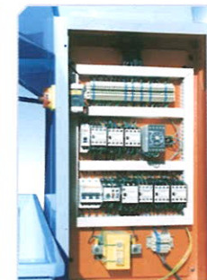
Özenle dizayn edilmiş elektik panosu Special designed electrical board
