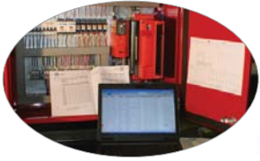
Kedi Elektrik Panosu Hoist Electrical Box
